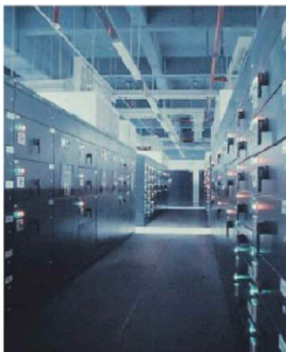
IA Immagine di archivio di un data center
