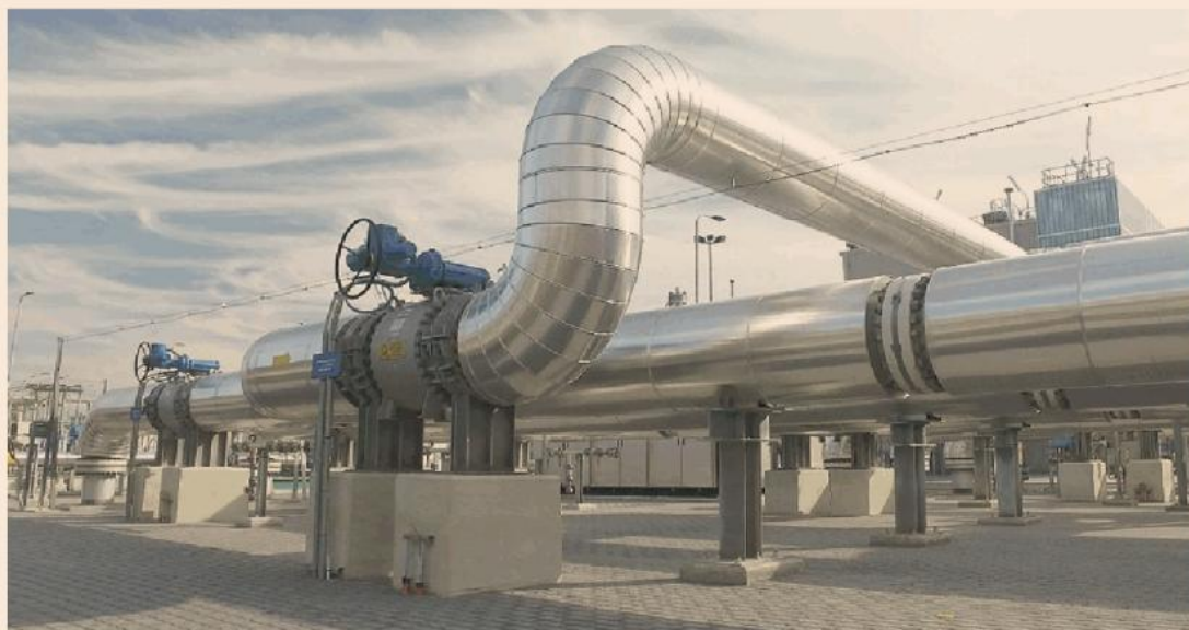
Sicurezza energetica. Uno dei gasdotti realizzati dal gruppo Snam
